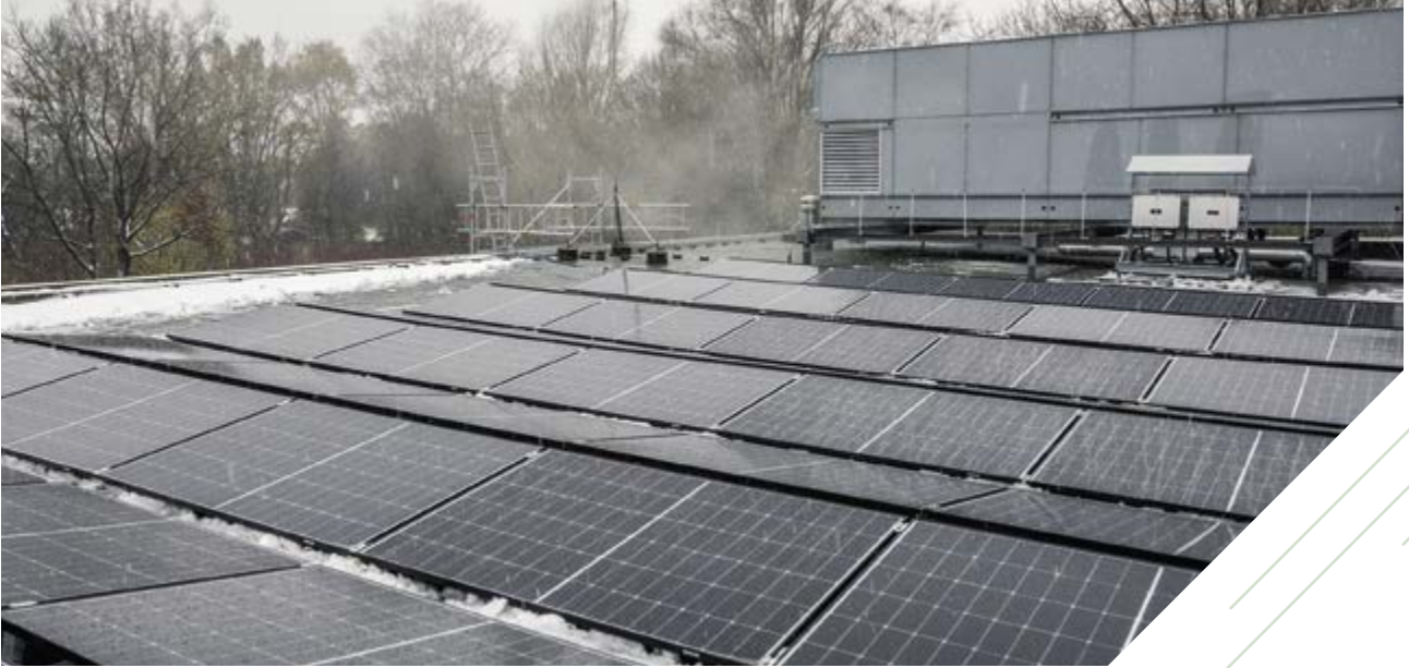
Photovoltaik-Anlage auf dem Dach des Bäderland Bramfeld
